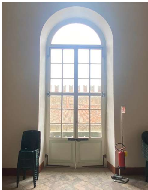
Foto 5 – serramento da restaurare
