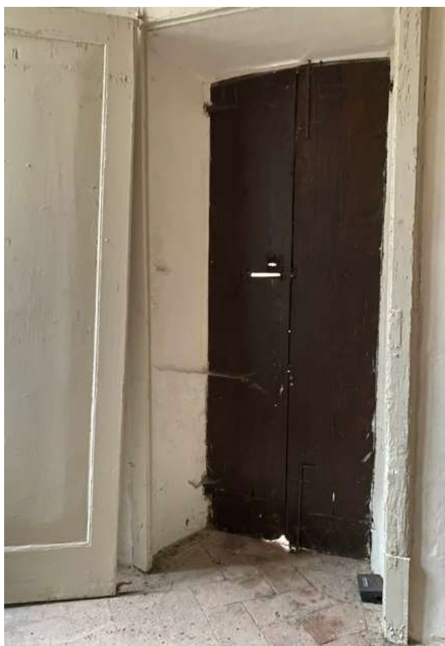
Foto 10- porte da restaurare
