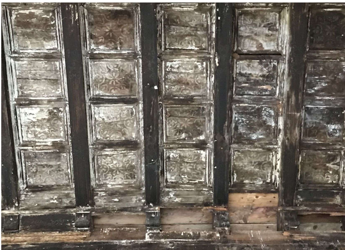
Foto 4- vista particolare cassettoni decorati, porzioni mancanti
