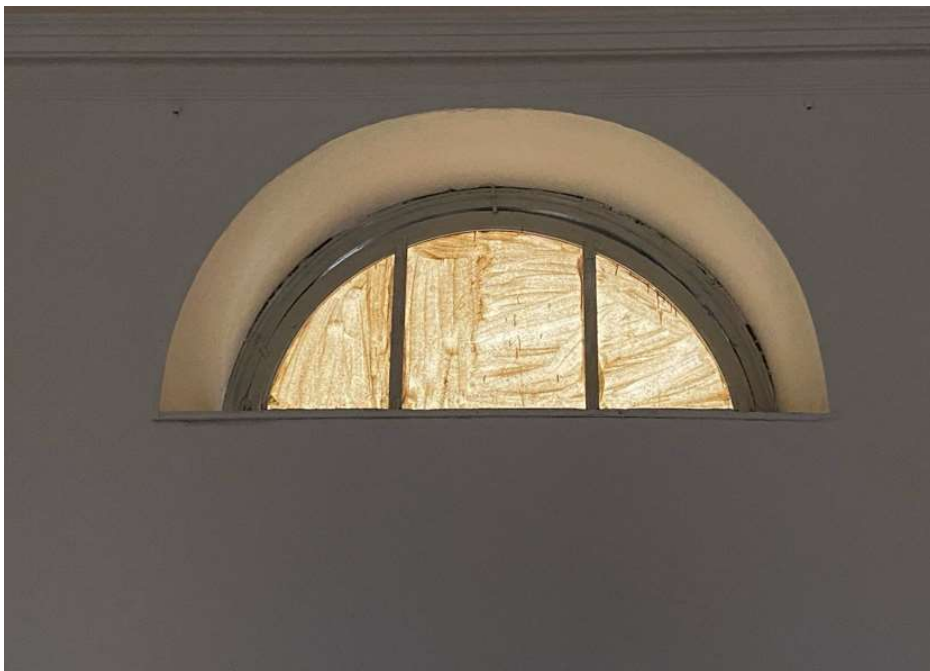
Foto 7 – serramento lunetta da restaurare
