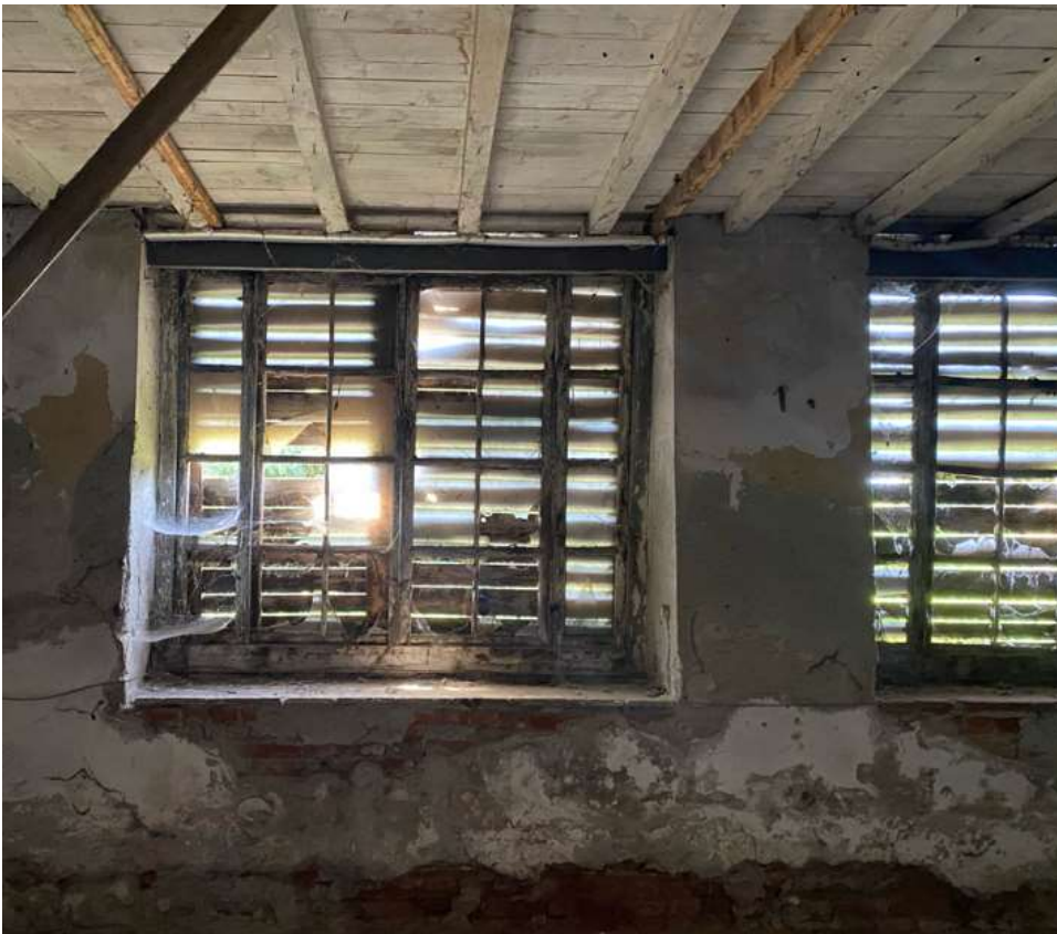
Particolare vista serramenti degradati
